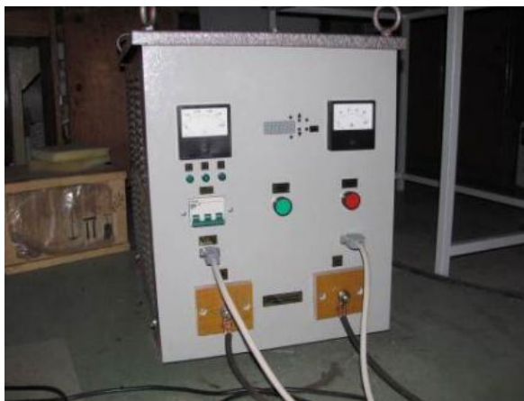
Рисунок 2.2 - Внешний вид источника питания установки электролитно-плазменной обработки.
