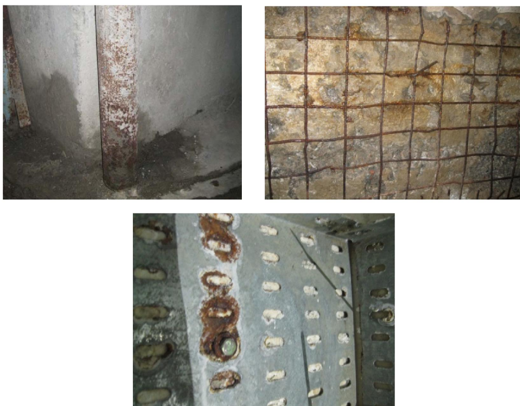
Рисунок – Поврежденные поверхности железобетонных конструкций
