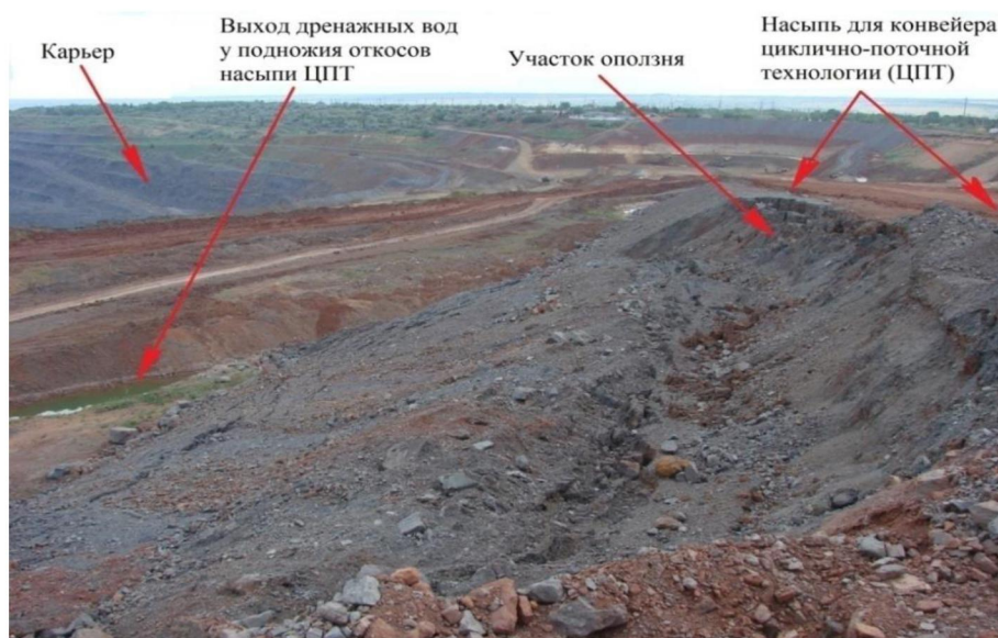
Рисунок 2 – Оползень насыпи ЦПТ
