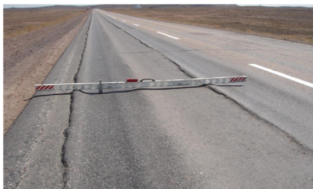
Рисунок 1 – Колея на асфальтобетонном покрытии автомобильной дороги
