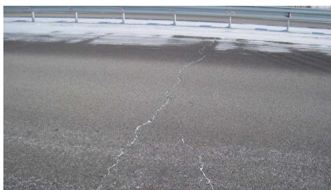
Рисунок 2 – Температурная трещина на асфальтобетонном покрытии автомобильной дороги
