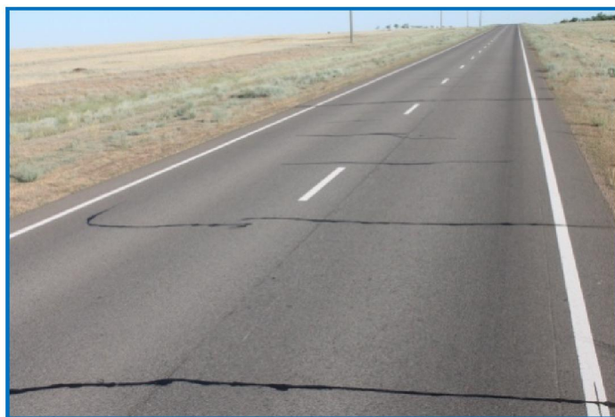
Рисунок 1 – Низкотемпературное растрескивание асфальтобетонного покрытия автомобильной дороги
