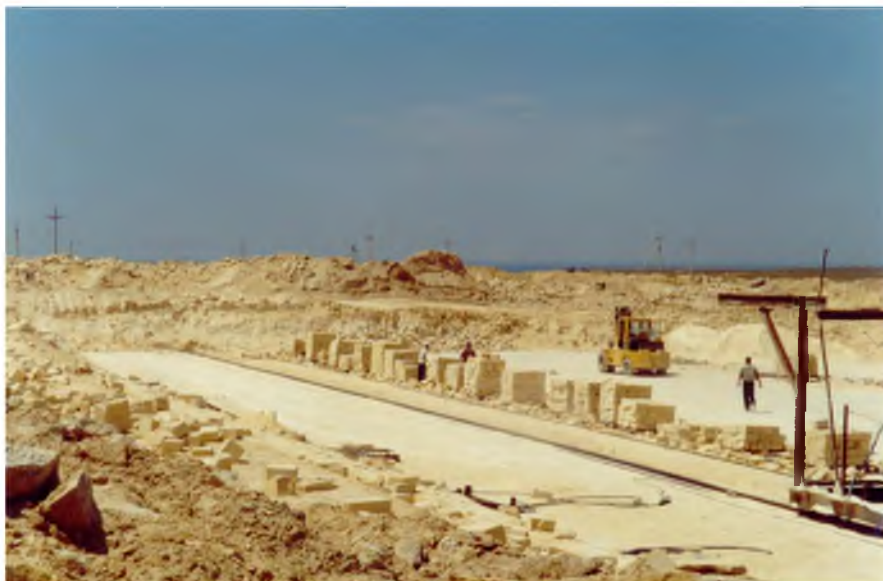
1-сурет – Ақтау қаласы маңында құрылыс материалдар өндіріліп алынып жатқан ашық кеніш (суретті түсірген Д. М. Боранқұлова, 2002)
