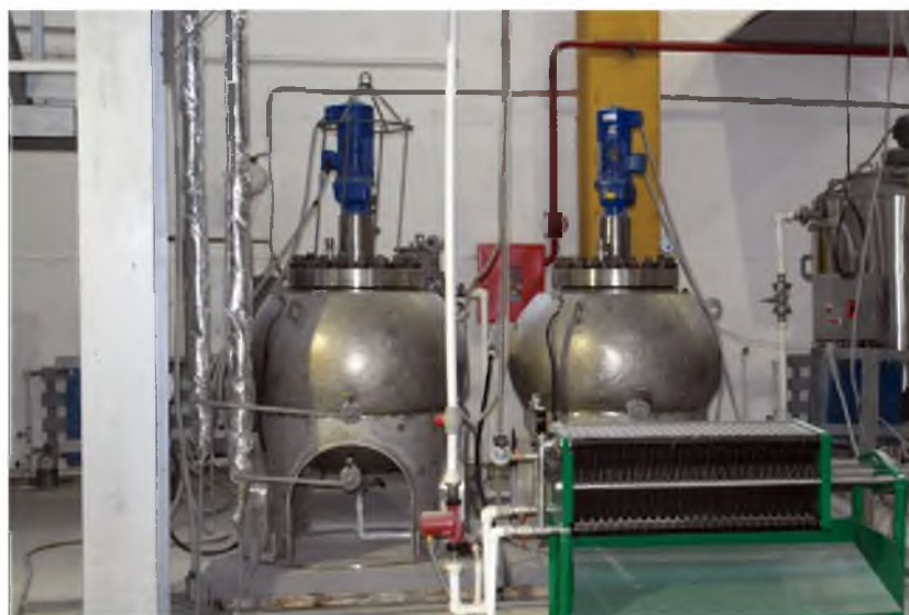
Рисунок 7 – Опытная установка на ОЭМП. Автоклавы объемом 500 литров
