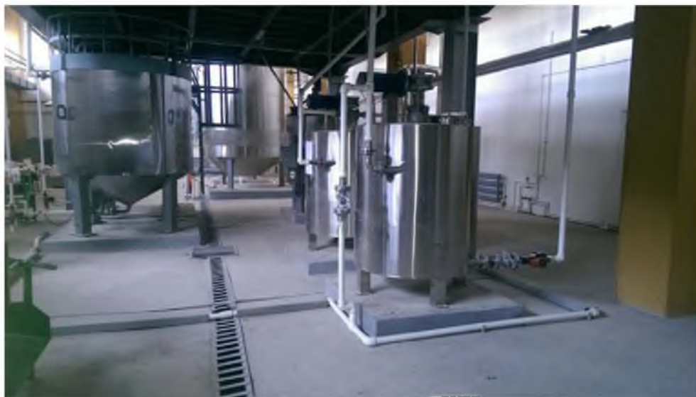
Рисунок 6 – Опытная установка на ОЭМП. Емкости сбора гидроксида алюминия и сырой пульпы, репульпаторы
