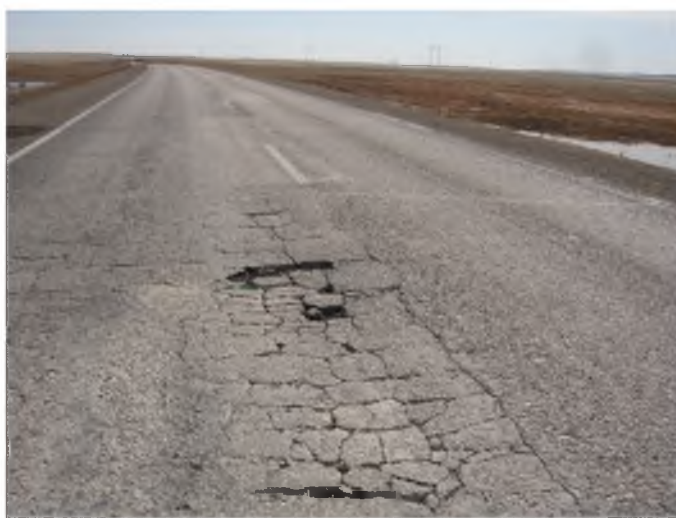
Рисунок 1 – Усталостная деструкция асфальтобетонного покрытия на участке (км 860) автомобильной дороги «Екатеринбург-Алматы»
