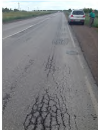
Рисунок 3 – Усталостная деструкция асфальтобетонного покрытия автомобильной дороги «Караганды-Шахтинск» (июль, 2016 год)
