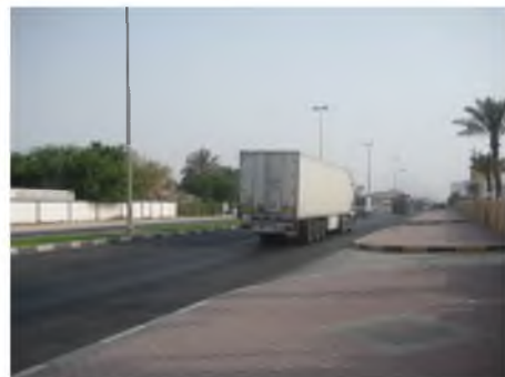
Рисунок 10 – Другие виды тяжеловесного автомобильного транспорта на участке дороги с усталостными трещинами (г. Шарджа, Объединенные Арабские эмираты, август, 2010 год)
