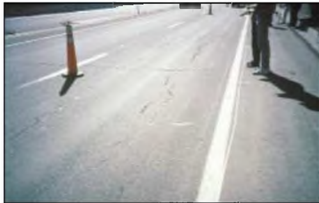
Рисунок 12 – Усталостная деструкция асфальтобетонного покрытия автомобильной дороги по Руководству [13]: низкий уровень
