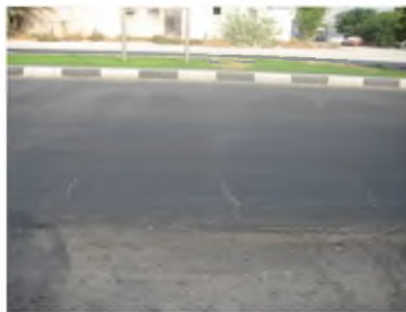
Рисунок 6 – Усталостная деструкция асфальтобетонного покрытия: поперечные усталостные трещины (г. Шарджа, Объединенные Арабские эмираты, август, 2010 год)
