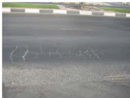
Рисунок 8 – Усталостная деструкция асфальтобетонного покрытия: сетка трещин типа «крокодиловая кожа» (г. Шарджа, Объединенные Арабские эмираты, август, 2010 год)
