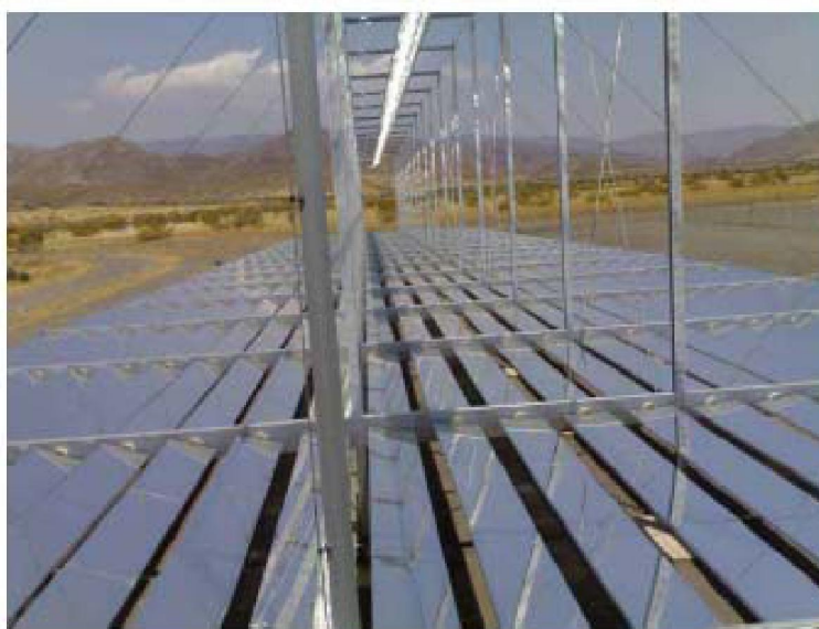
Рисунок 1.1 – ФЭ электростанция мощностью 23 МВт, Алмерия, Испания [3,8,11].
